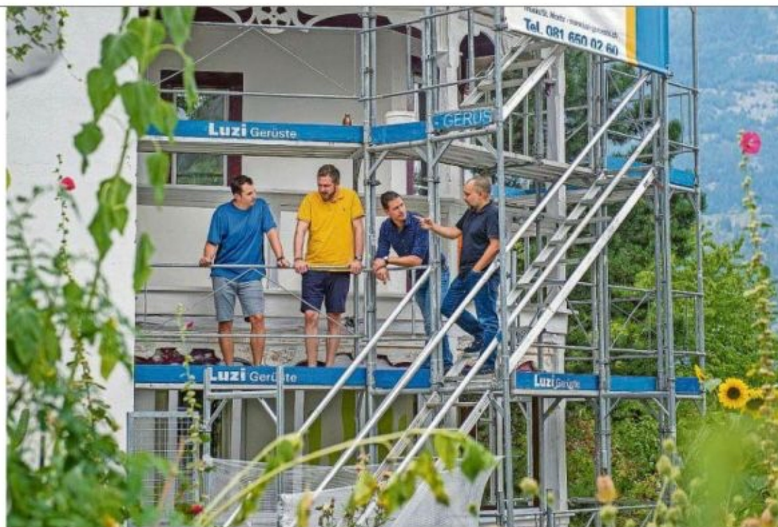
Hilfe mit Körpereinsatz: Carlo Schneider diskutiert mit Adrian Ciardo, David Naef und Sven Theus (von rechts) den Fortgang der Sanierungsarbeiten an der Fassade.
